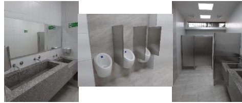
Adecuación y remodelación de baños en la Biblioteca "Misael Díaz Urzola" de la Universidad de Córdoba, sede Montería.
